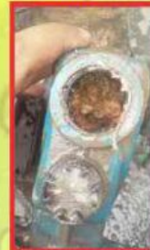
Pompa Air Berkerak Tebal
